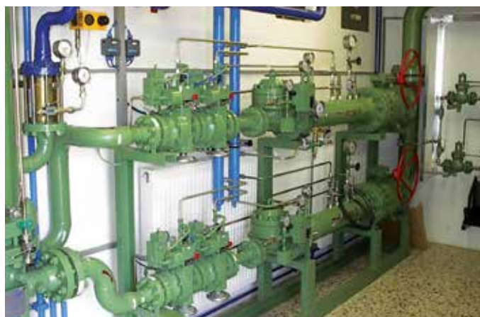
Рисунок 6 – Установка для редуцирования газа в помещении
