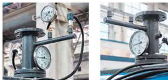
Пример установки приборов КИПиА на проставках
